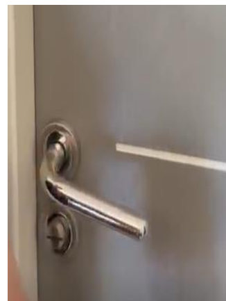
Figure 3 Poignée de porte aménagée
